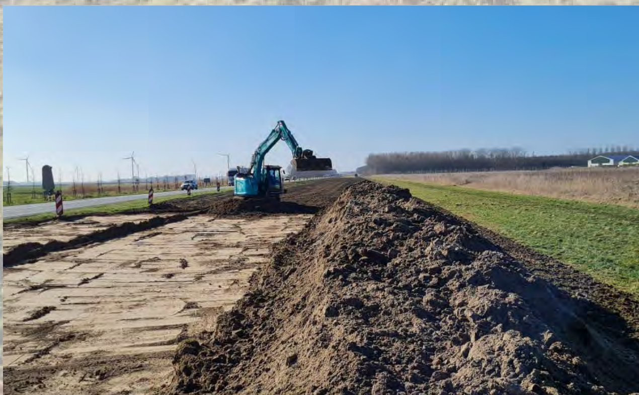
Foto: er wordt gemaaid en gefreesd om het grondbed klaar te maken voor de aanleg van het asfalt
